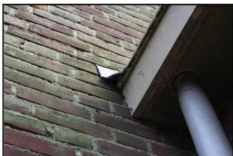
Foto 11: Kieren onder loodflappen
